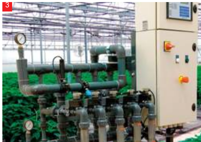
3 Banco di fertirrigazione computerizzato.
