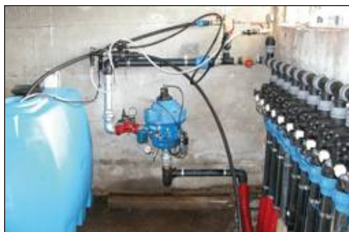
[ Centralizzazione della fertirrigazione al servizio di tutta la superficie aziendale.
